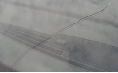
Breuk welke niet meer te herstellen is Niet acceptabel
