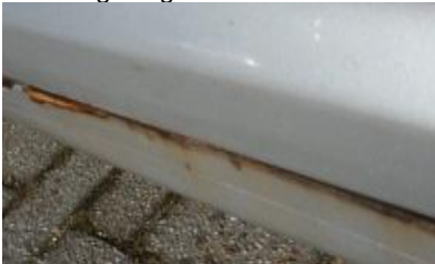
Roestschade als gevolg van schade Niet acceptabel
